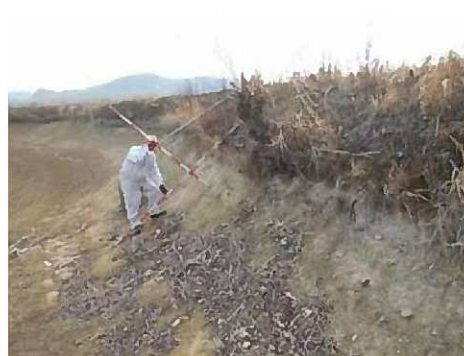
堤体の浸食状況
