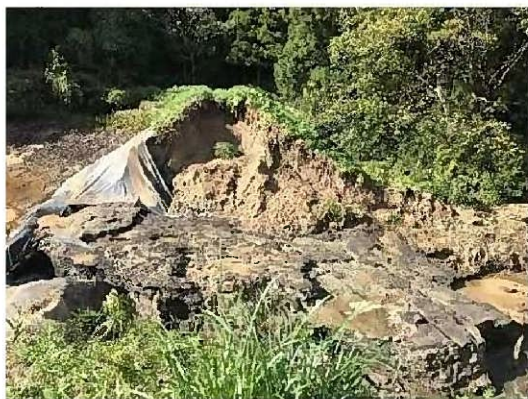
【宮城県白石市 逆川下溜池：決壊断面】
