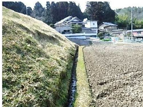
後法 はらみだし及び陥没
