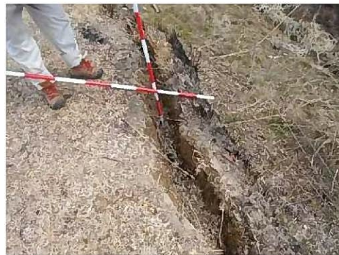
堤頂 ひび割れ
