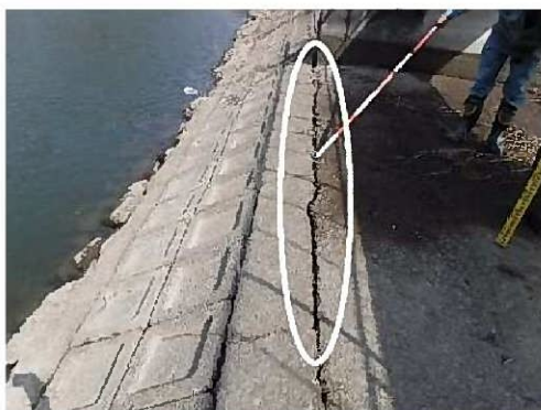
流入部 ひび割れ
