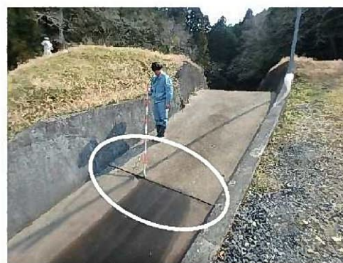
放水路部 漏水
