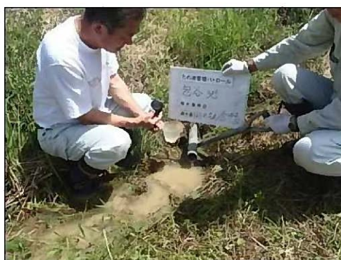
後法 漏水(近景)
