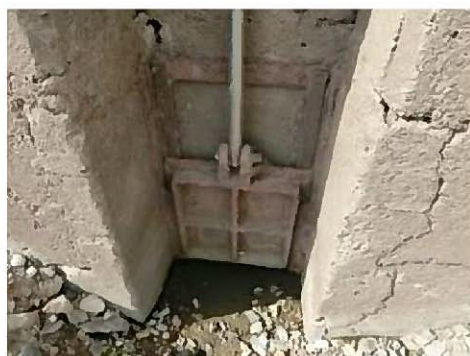
土砂吐ゲート部 腐食及びクラック
