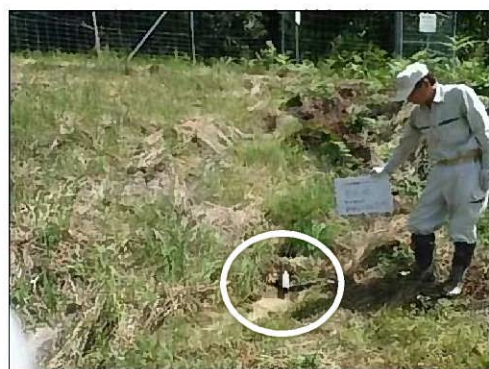
後法 漏水(遠景)
