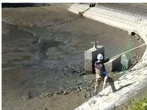
泥土堆積状況(かいぼり実施前)
