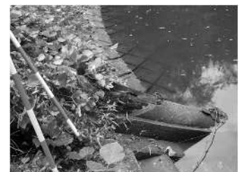
斜樋躯体が損傷、蓋も脱落し、貯水能力が低下
