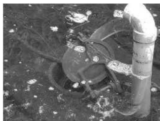
小枝がため池栓に入り込み、取水能力が著しく低下
