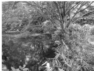
雑木により堤体内に亀裂が生じ、決壊する危険性あり
