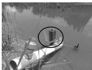
足場がなく、取水調整が困難な斜樋(塩ビ管)
