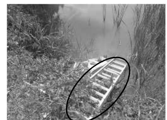
梯子を設置し、操作性と安全性を改善した事例
