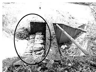
貯水量を増やすために土のうを設置、堤体越流の危険大
