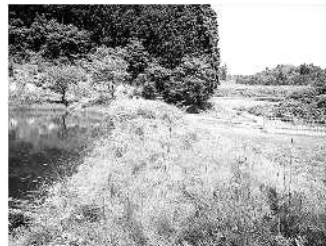
堤体の草刈りが不十分なため、変状の発見が困難
