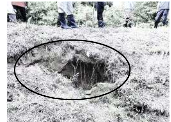
堤体に穴が発生し、貯水不能(対策工法を助言)
